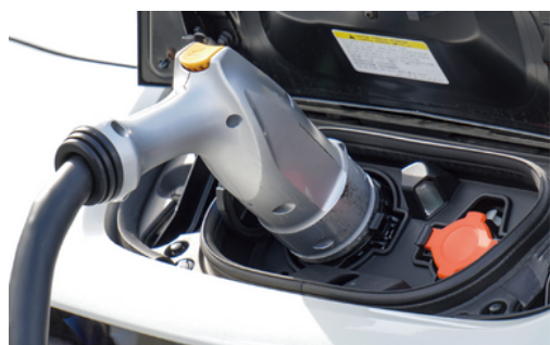
EV コンセント
